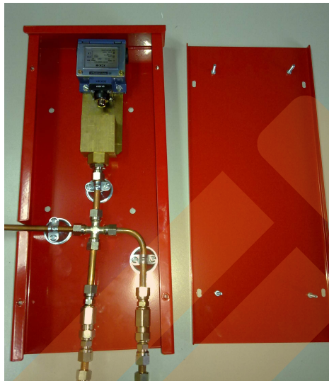
Foto: Detalle de la caja de distribución conexiones líneas CO 2 . Con contacto TELEMECANIC para corte de suministro eléctrico de las bombas de combustible y activación alarma de la estación de servicio.
