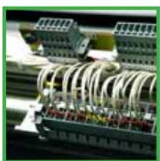
Armarios eléctricos y subestaciones
