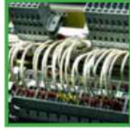
Armarios eléctricos y subestaciones
