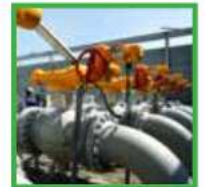
Instalaciones de gas
